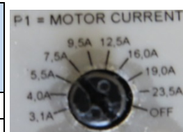
Figure : P1 d'un démarreur de 7,5 kW
