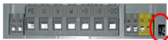
Partie inférieure des appareils
